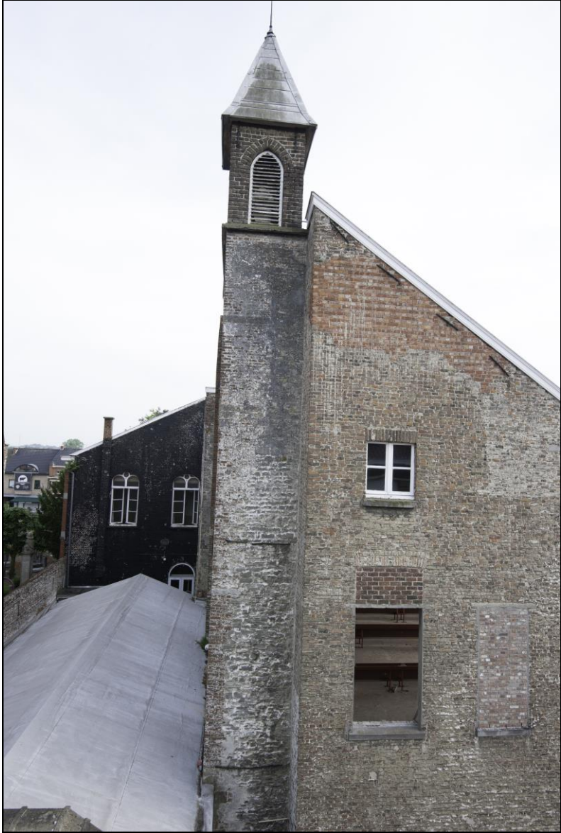
Het klokkentorentje en op de rechtergevel de restauratie in bleke baksteen van na WOII.
