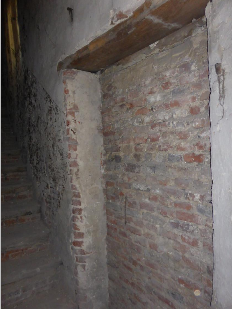
De (later gedichte) doorgang naar de eerste verdieping van uit de trap gezien. De linkerstijl is herwerkt in baksteen en een houten latei is aangebracht.
